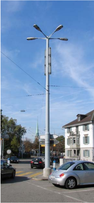
Solitärmast, bestückt mit sechs Projektoren
